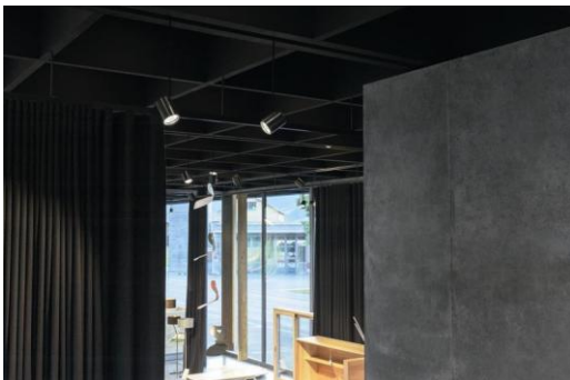
Bild 4: Mit einer speziell angefertigten Abhängung positionierte Zumtobel in diesem Bereich etwa 160 LED-Spots der Serie Panos Infinity. Die Strahler sind auf Tecton-Schienen montiert.
